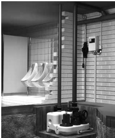
Рис. 106. Пример установки Multilift MDG в прямке в подвальном помещении здания
